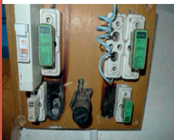
Branchements d'électricité vétustes
