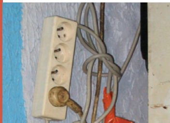
Installation électrique dangereuse
