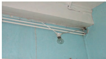
Eclairage insuffisant et dangereux
