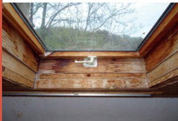
Absence de protection contre les infiltrations d'eau
