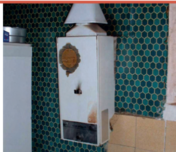
Absence de dispositif d'évacuation des gaz brûlés
