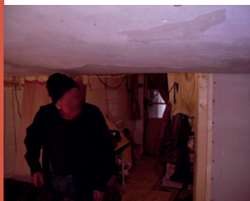
Hauteur sous plafond insuffisante
