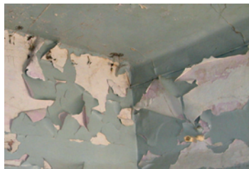
Peinture écaillée contenant du plomb
